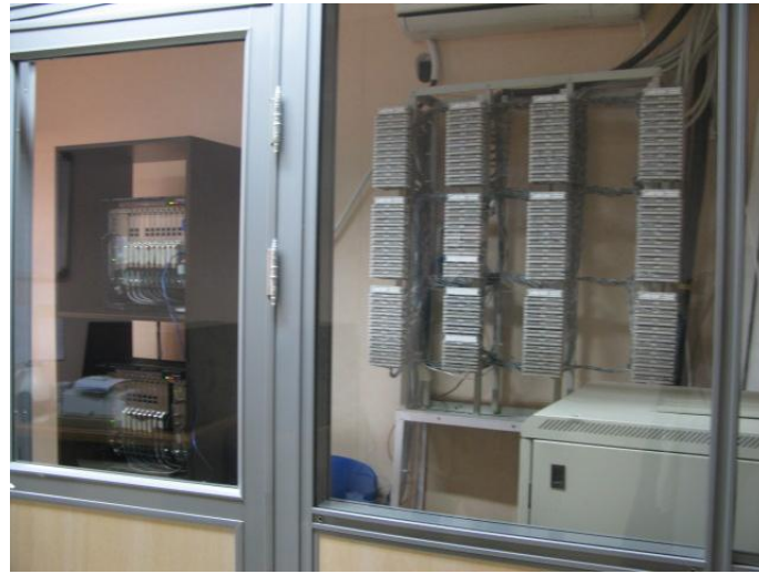
اتاق مخصوص تجهیزات
